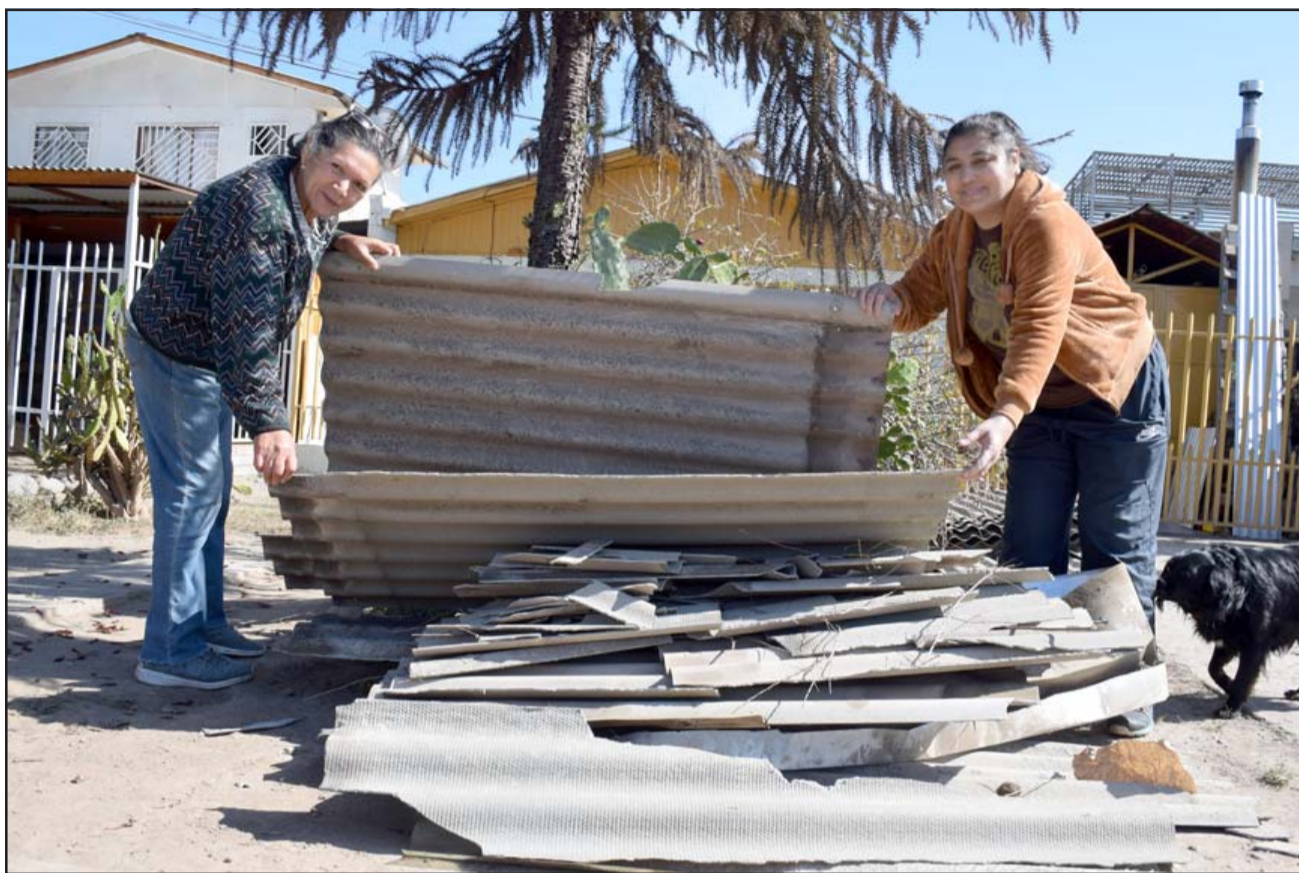
INVIERNO SIN GOTERAS.- Las cámaras de Diario El Trabajo captan a Valeria y su madre Elena Soto, removiendo escombros de asbesto cemento, luego que manos solidarias les cambiaron la dañada techumbre.
