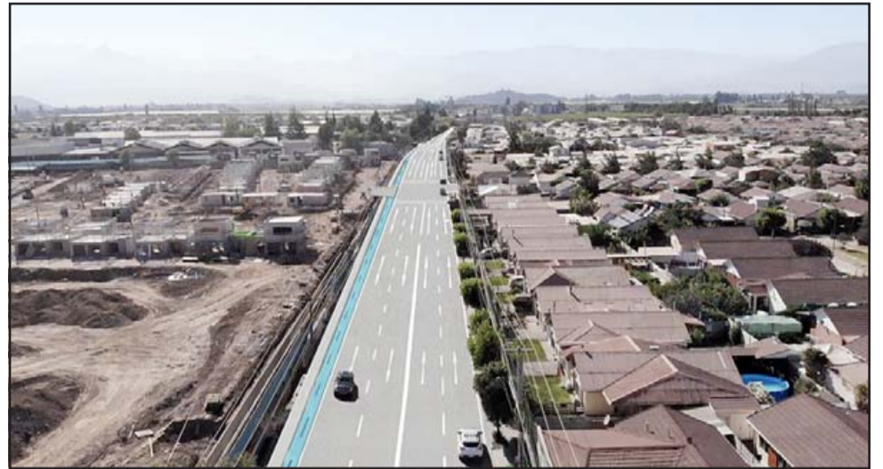
Así quedará la Avenida Michimalongo una vez que estén terminados los trabajos, con cuatro pistas de circulación, formando parte del mega proyecto 'Circunvalación San Felipe' junto a los trabajos en Avenida Hermanos Carrera el año 2020.
