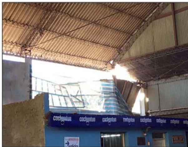
Falta de cerco y cierre de gimnasio que está dentro de zona de conservación histórica.
