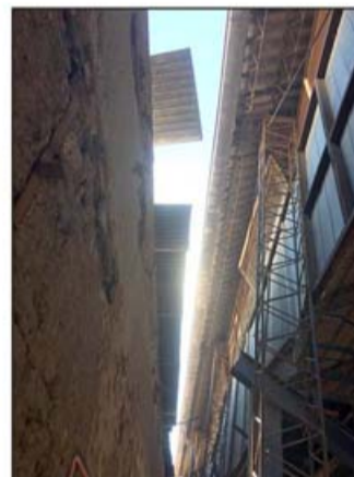
Estado de techo del Gimnasio Arturo Prat y actual centro vacunatorio, que constituye una obra ruinosa.
