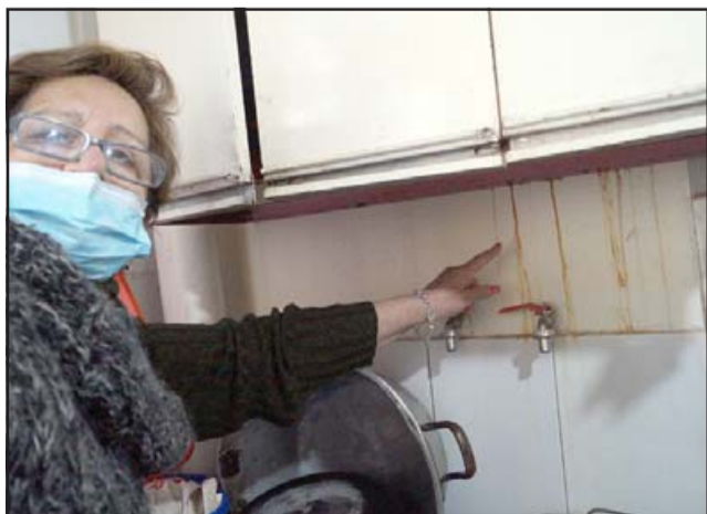
EN PLENA COCINA.- Doña Clara Cornejo en el segundo piso, nos muestra cómo chorrean las paredes de su cocina, óxido y otras fragancias se perciben.
