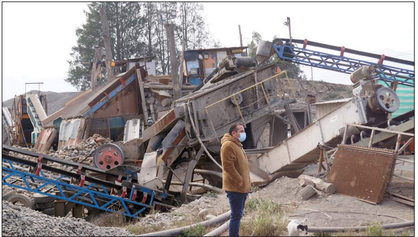
CON PATENTE SUSPENDIDA.- Las cámaras de Diario El Trabajo registraron la mañana de este miércoles las faenas paralizadas en Áridos Encón.
