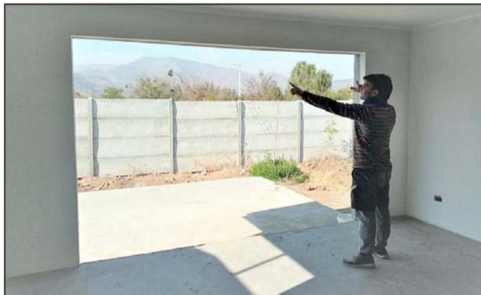
Acá estaba uno de los ventanales robados, en total serían más de $2 millones en pérdidas.
