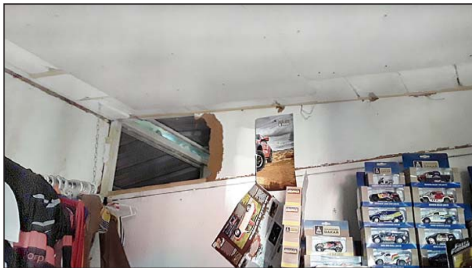
Este es el forado que hicieron en el local N°11 de Rodrigo Navarro, el más afectado.
