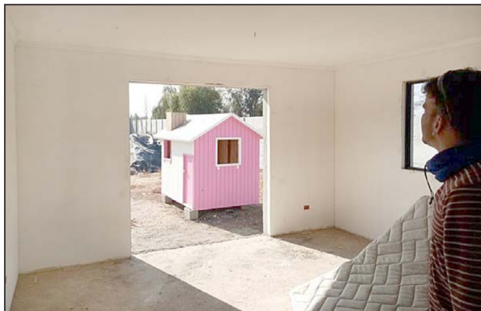
Acá estaba otro de los ventanales que fueron robados desde la casa ubicada en Quebrada Herrera.
