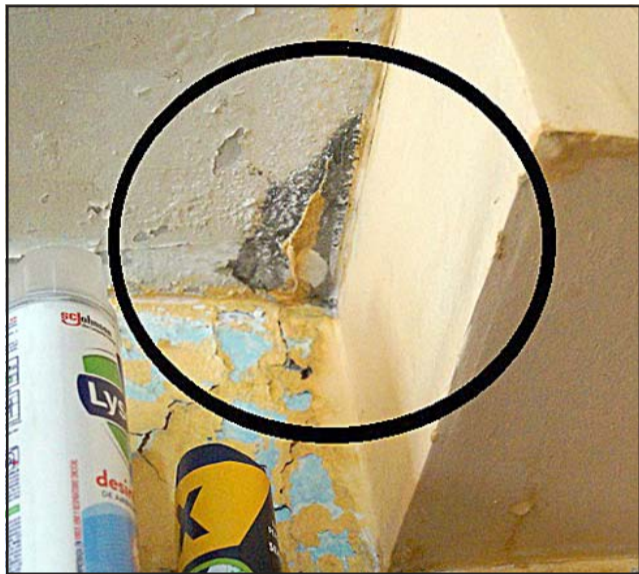
SOLICITA AYUDA. - En algunas esquinas del inmueble hay pequeñas grietas por donde ingresa el agua.
