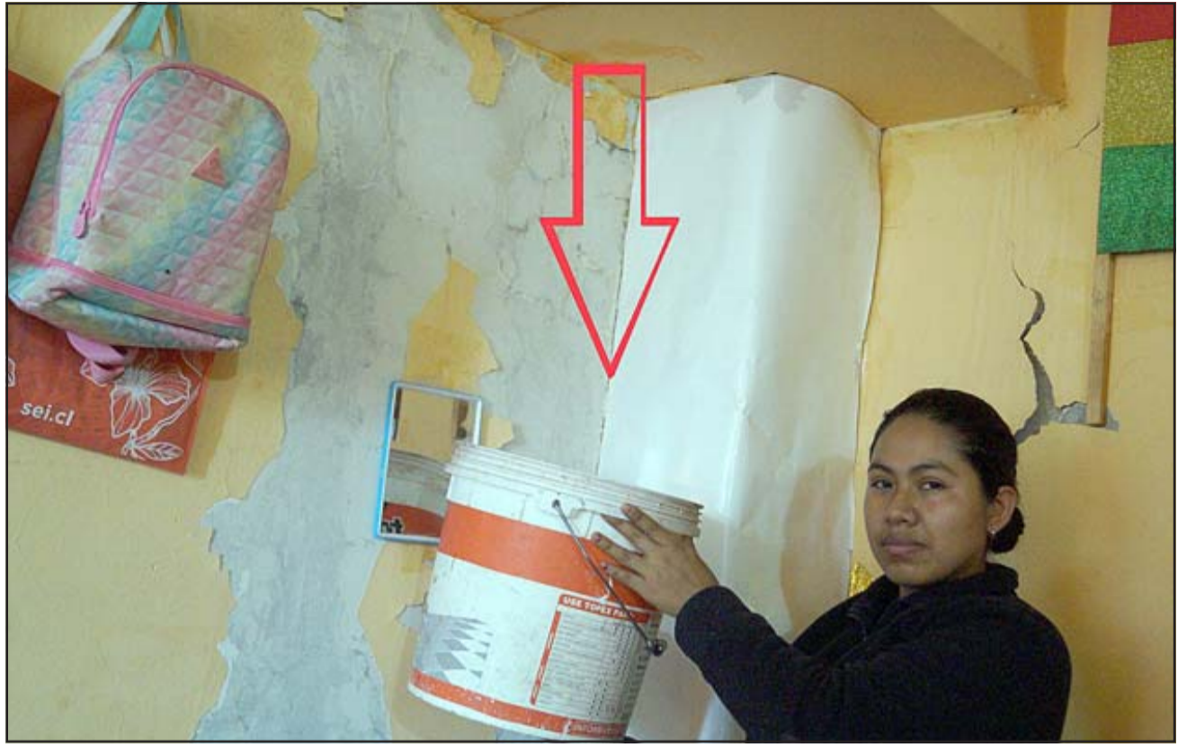
FILTRACIÓN POR LAS PAREDES. - Aún en nuestra presencia algunas gotas de agua caían en este recipiente, esta joven madre solicita le echen una mano.
