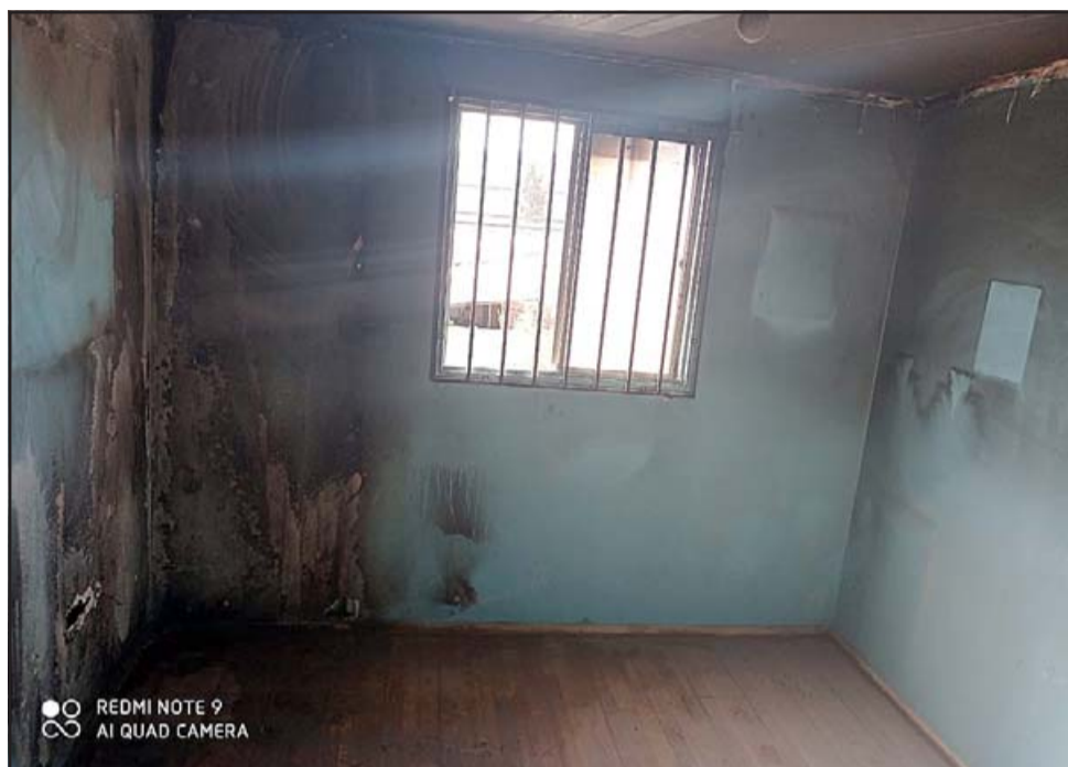
En la imagen se aprecian los daños en la habitación donde se originó el incendio.
