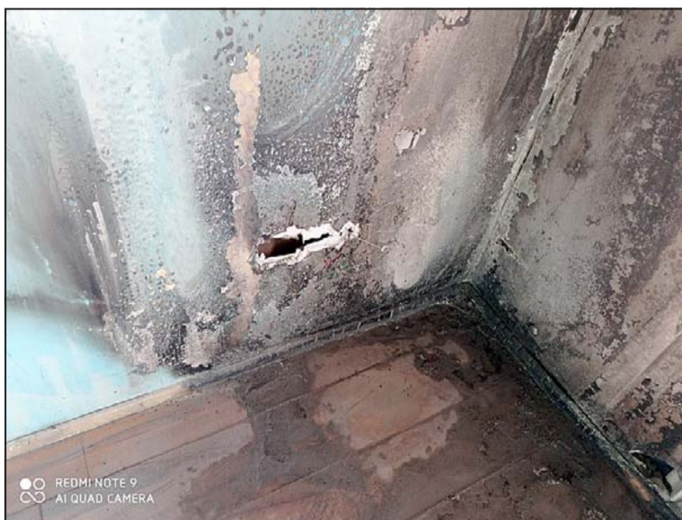
El agua y el fuego causaron bastante daño en las paredes.
