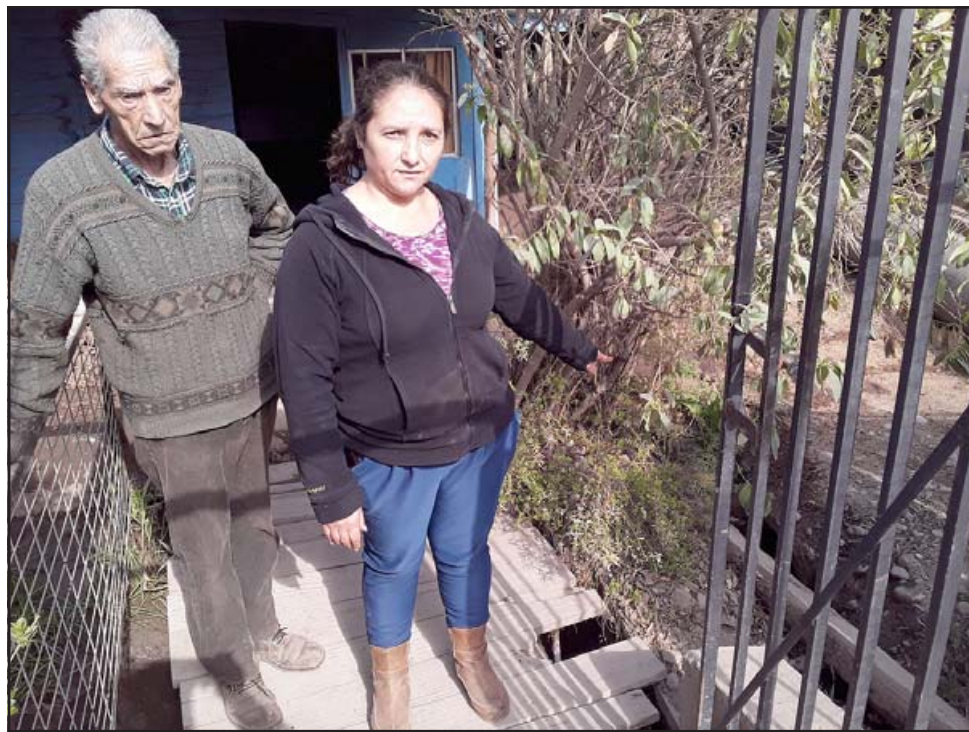
Bernarda junto a su padre sobre el puente de madera. Abajo está el tubo que colapsó por la gran cantidad de agua.
