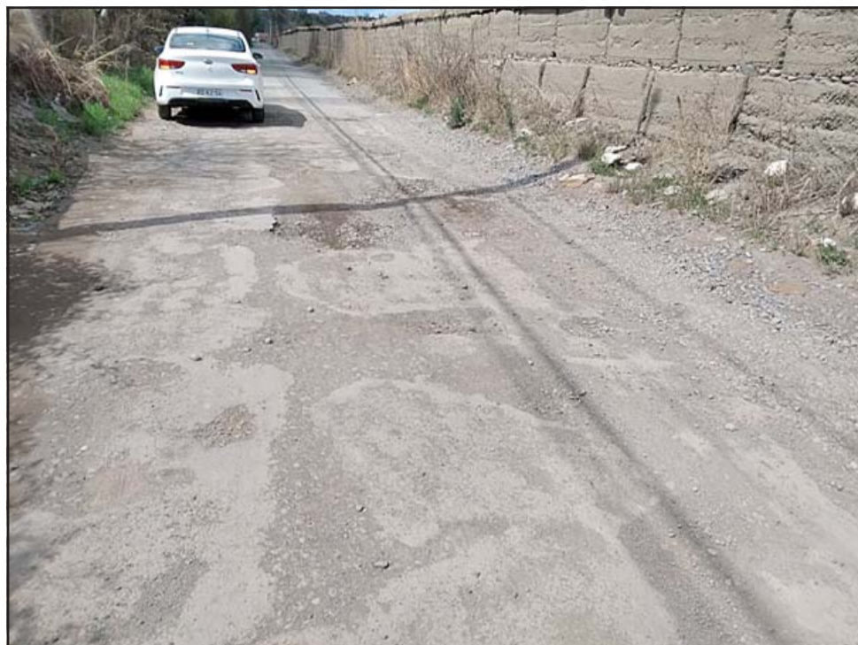
Enormes hoyos deben sortear los vehículos en calle El Convento.
