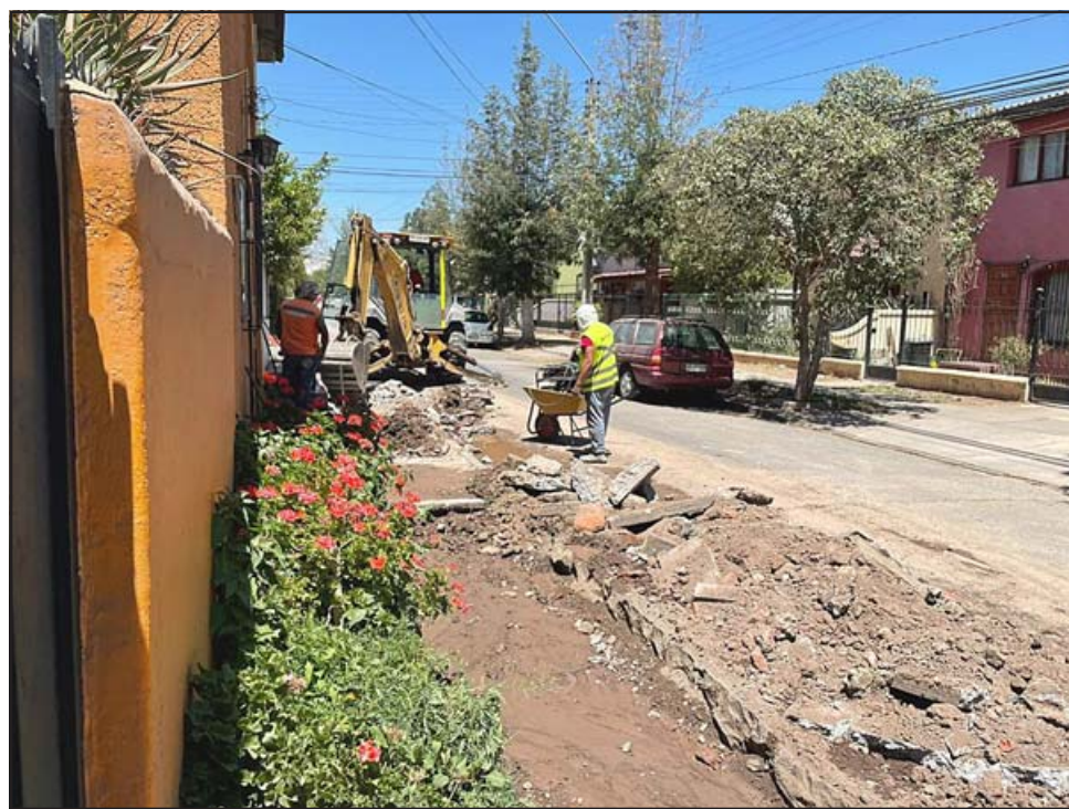
Obreros trabajando en la vereda de calle Joaquín Oliva. Las máquinas y la tierra son el principal problema. Súmele la rotura de cañerías que dejó sin agua a los vecinos.
