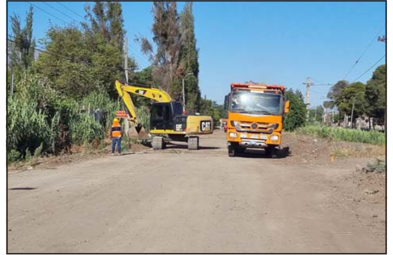
Finalmente, después de muchísimos años de espera y un arduo trabajo por parte del municipio de Llay Llay, comenzaron los trabajos de construcción de Avenida Ferrocarril.
