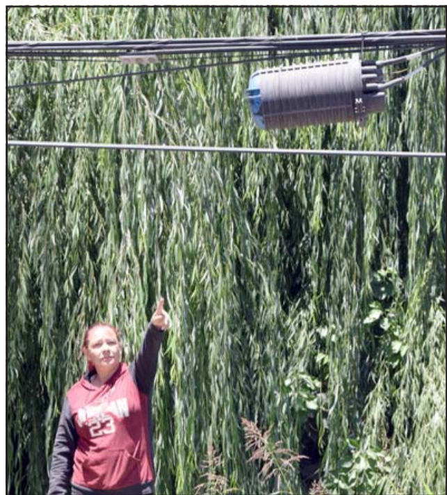
LA LEY DEL MÍNIMO ESFUERZO.- Hasta los cables de alta tensión y comunicaciones están a medio caer en la vía pública, es un abandono de deberes tan claro como el agua.
