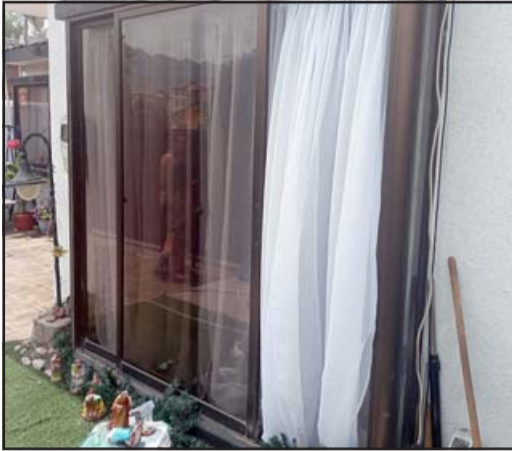
Por este ventanal ingresaron los delincuentes
