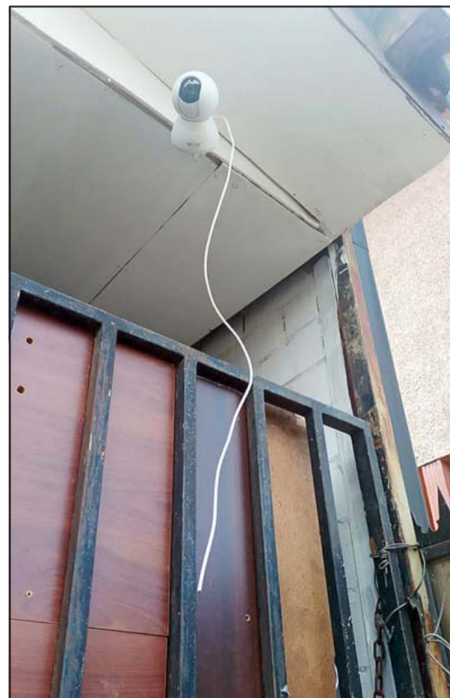
La cámara instalada fue sabotada por los delincuentes que procedieron a cortar el cable.
