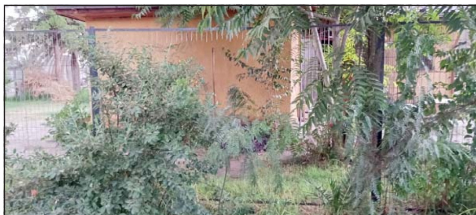
Acá fue donde robaron malla Acma que sirve de cierre perimetral para la sede vecinal.
