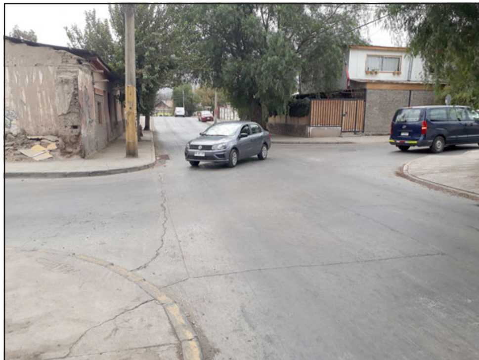
Pese al intenso flujo vehicular que registra este cruce, el paso peatonal se encuentra sin pintar.
