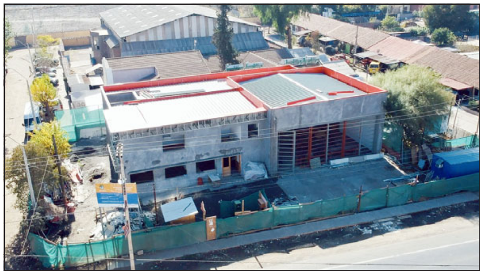
La construcción del cuartel de Bomberos de Curimón quedó abandonada en diciembre del año 2020.
