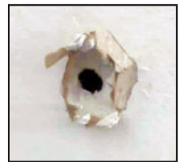
El orificio que dejó la bala loca en el cielo del inmueble, luego de atravesar el techo y dos cubrecielos.
