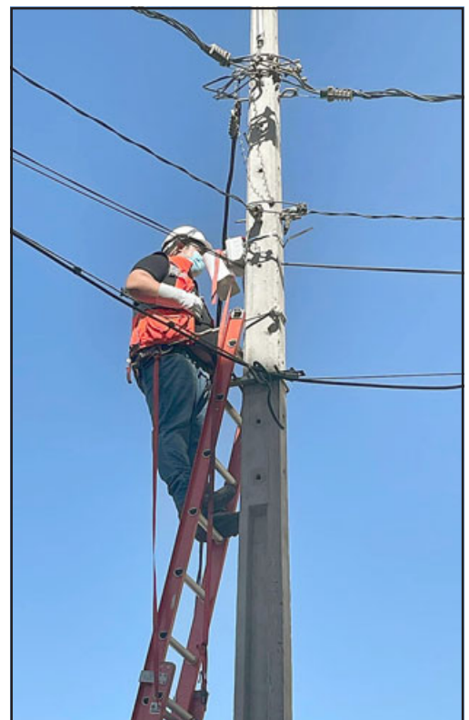
Esta semana se instalarán las alarmas comunitarias en la población Yungay y en la Villa El Señorial.
