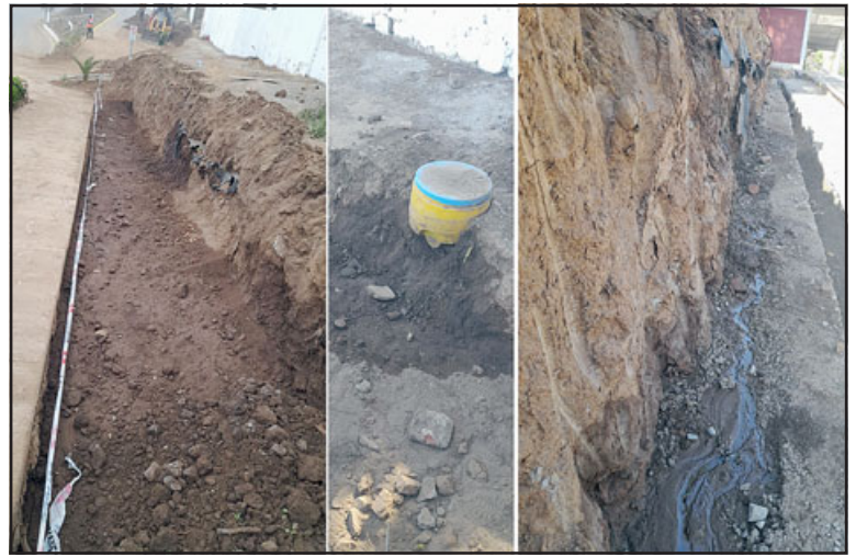
EN GUERRA AVISADA... - Acá vemos las filtraciones de aguas negras en la obra en desarrollo, al centro vemos una cámara rebalsada de líquido, y a nuestra derecha el muro de tierra a punto de colapsar.
