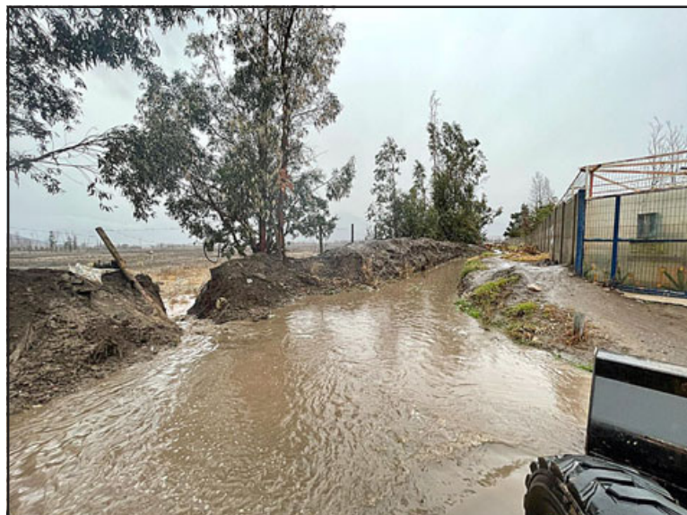
El sector poniente de la ciudad recibe las aguas que escurren de prácticamente toda la comuna, obligando a practicar movimientos de tierra para enfrentar la inundación.
