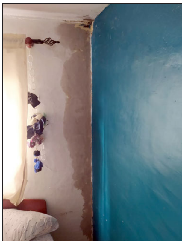
En la imagen se puede apreciar la pared que luce totalmente mojada.
