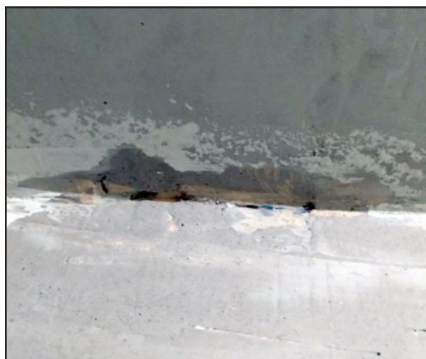
En las uniones del cielo raso también se aprecia la humedad.
