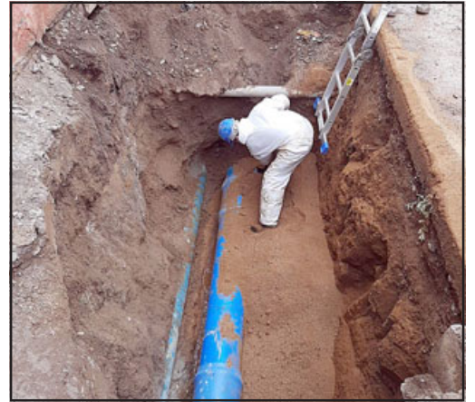
Las obras consideran el recambio de 257 metros de colector en calles Toro Mazote y San Martín.
