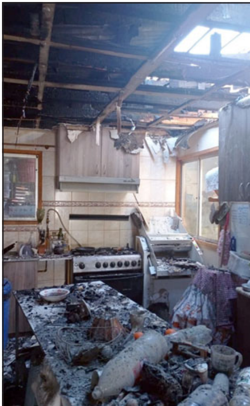
Estos son los daños que dejó el incendio en casa de Gioconda Muñoz.
