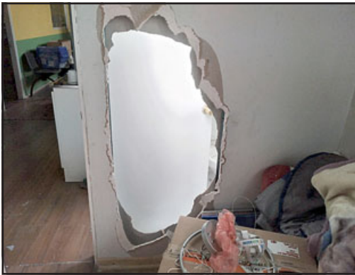
Este fue el daño que provocaron en la pared para ingresar al establecimiento.
