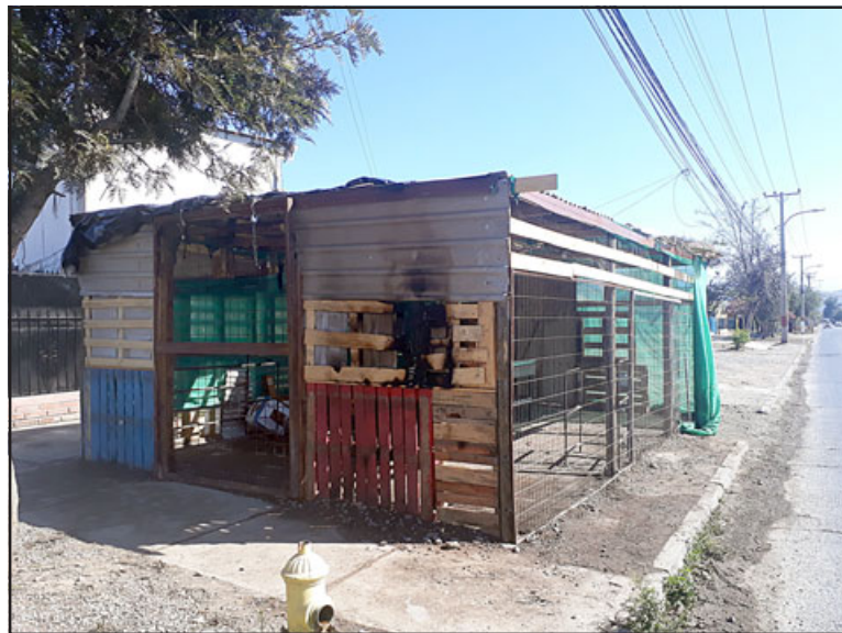
Acá se aprecia el daño por el fuego en una de las esquinas de la ramada.
