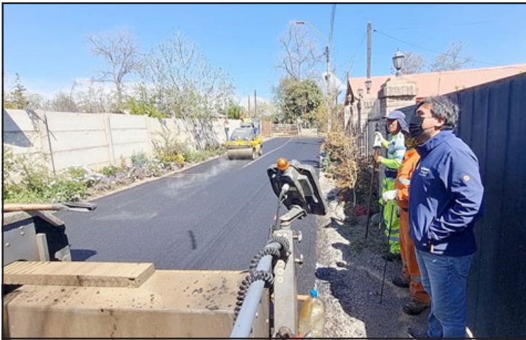
Los trabajos comenzaron a concretarse esta semana, en una obra que tendrá una duración de tan sólo cuatro días.
