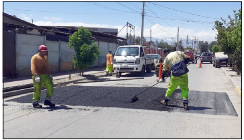
Municipio comenzó la construcción de más de 30 reductores de velocidad en San Felipe.
