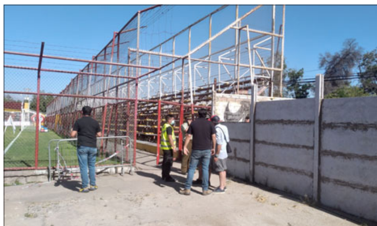
Hincha de Fernández Vial derribó una de las panderetas del Estadio Municipal.
