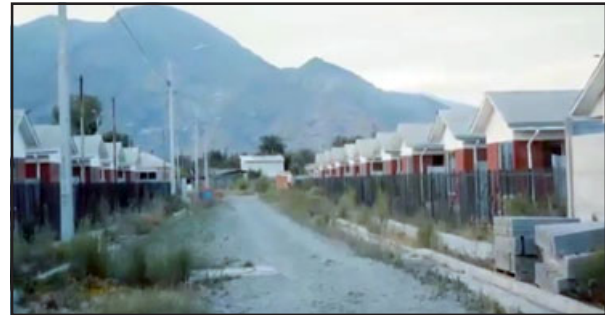
Construcción de viviendas del comité 'Los Nogales I' de Catemu está paralizada desde el mes de febrero.
