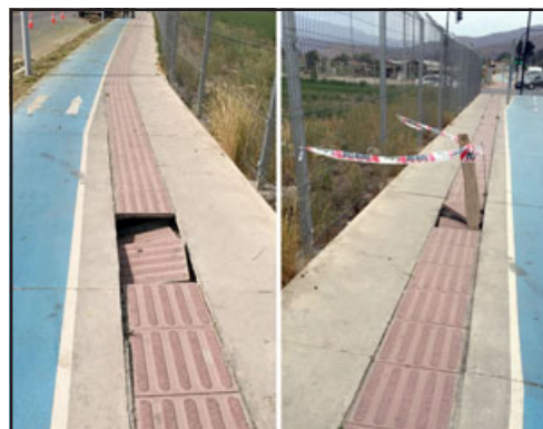
Las baldosas están prácticamente colgando, hundiéndose en lo que parece ser un socavón en el piso. Por suerte alguien puso un madero como señalización para evitar caídas.
