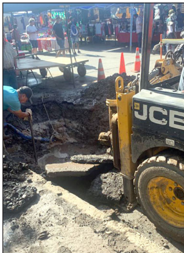
Un trabajador efectuando labores en el lugar donde se rompió la matriz.
