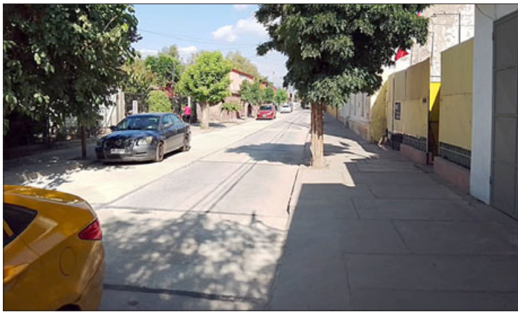
La semana recién pasada concluyeron los trabajos en calle San Martín, quedando habilitada la vía para tránsito vehicular.
