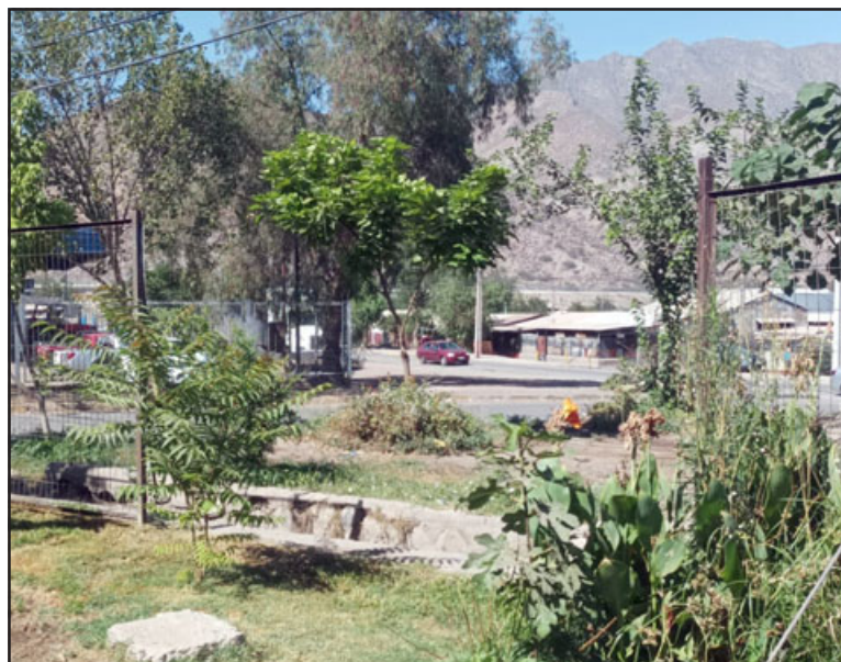
Así quedó la reja de la sede vecinal de la Villa Sol del Inca, luego que un delincuente se robara 4 metros lineales de la estructura.
