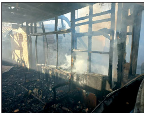
Tanto la estructura de la vivienda como los muebles fueron arrasados por el fuego.
