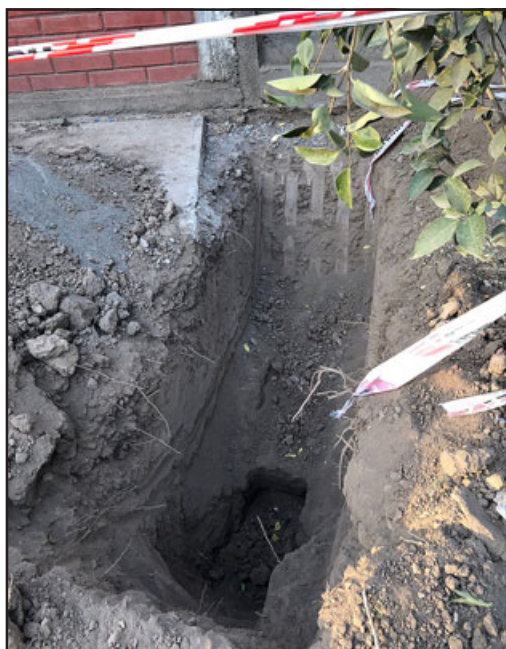
Esta es la zanja a la cual la señora Nubia cayó, según indicó, por no estar señalizada.
