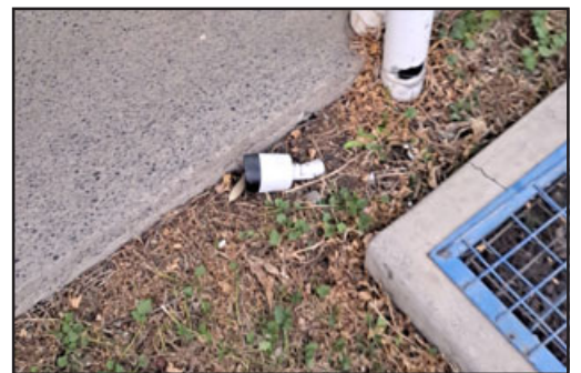
Una de las cámaras tirada en el suelo.
