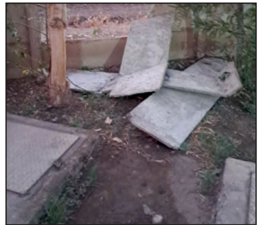
No sólo es el robo, también es el daño que hacen al romper las panderetas y dejarlas en el suelo.
