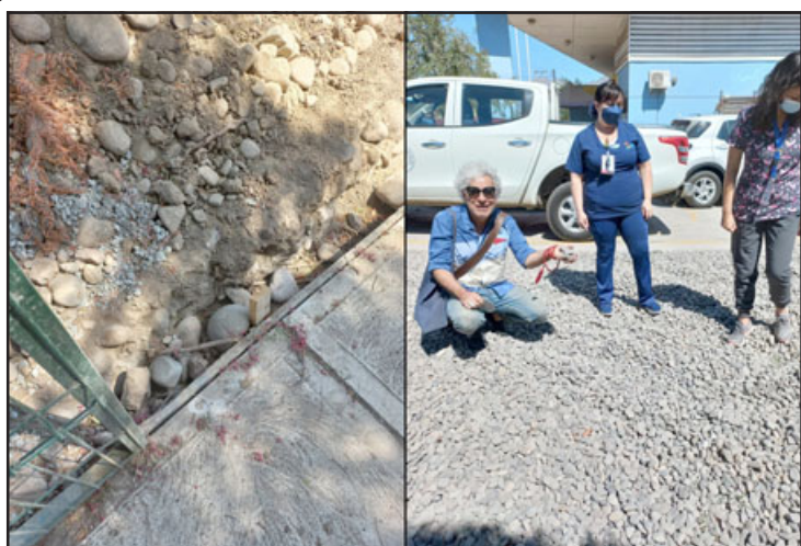
Diversas deficiencias advirtió el concejal Sabaj en visita al lugar.
