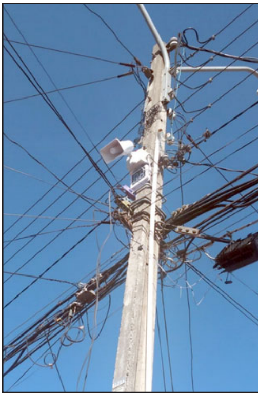
'ESTAMOS SOLOS'.- El sector es considerado como 'No Vulnerable', por tanto no pueden optar a beneficios como las alarmas comunitarias. Por eso deben arreglárselas como puedan, al fin y al cabo están solos.
