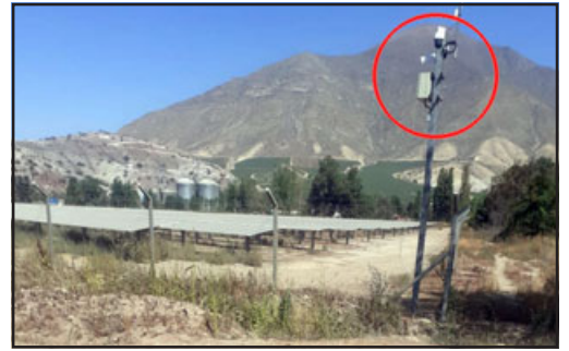
Estos son los paneles solares. Arriba, en el círculo rojo de la imagen, se ve la sirena de la alarma que no deja dormir a los vecinos.
