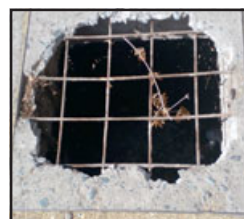
Una imagen más cerca del deterioro en que se encuentra la tapa de alcantarillado.
