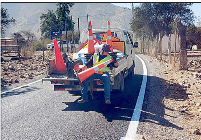
Señaléticas temporales y fijas que se colocan en el sector.
