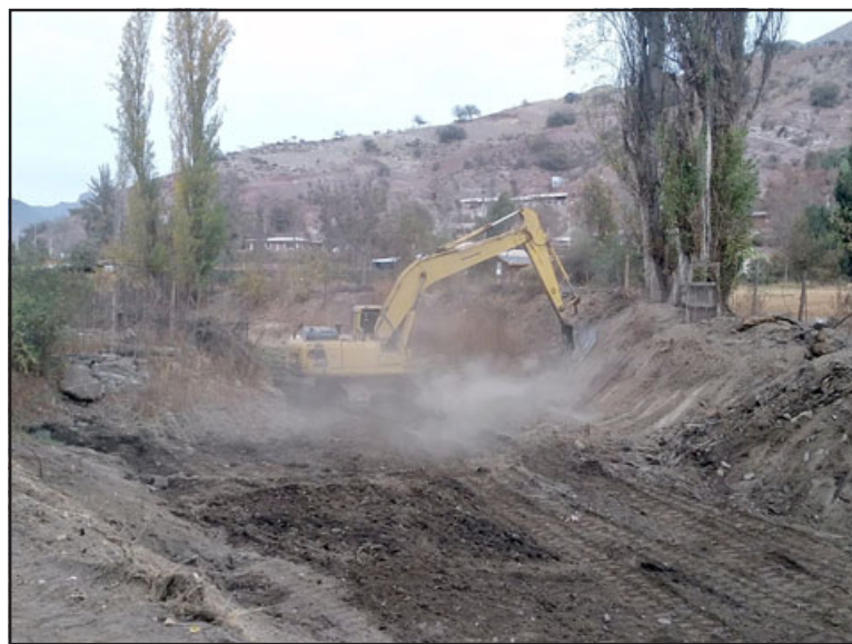
Con maquinaria pesada se realizó la limpieza del estero Pocuro en el sector de Tierras Blancas.
