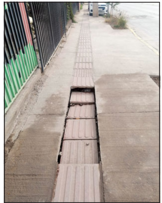
Esta es la parte de la vereda que se hundió en la avenida Michmalonco.
