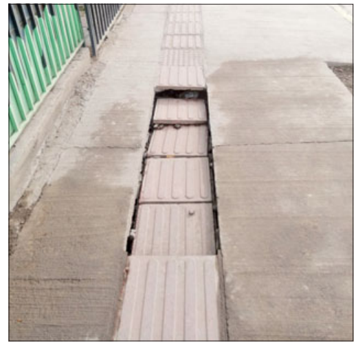
La filtración en una matriz de agua provocó el hundimiento de la vereda en la nueva avenida Michimalonco, situación que ya fue reparada.
