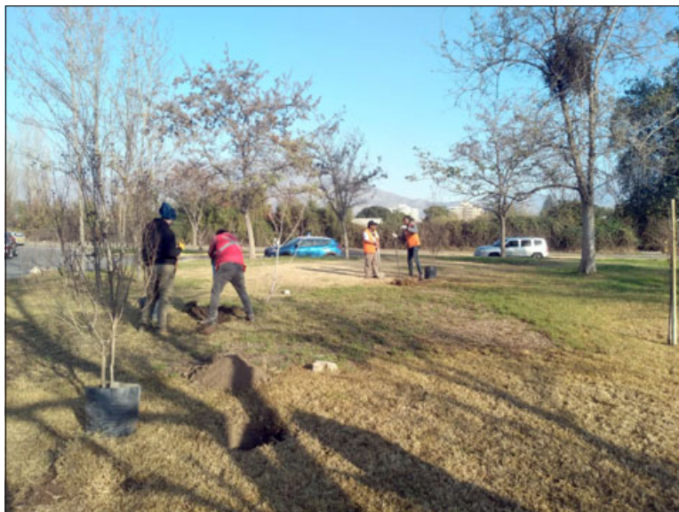
Con la plantación de árboles comenzó el trabajo en la rotonda 'Círculo de los 21'.
