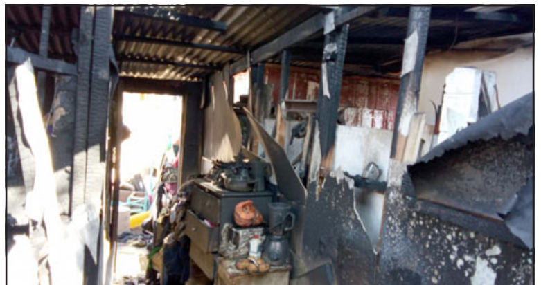
El fuego avanzó rápidamente debido a la utilización de líquidos inflamables como bencina y parafina.
