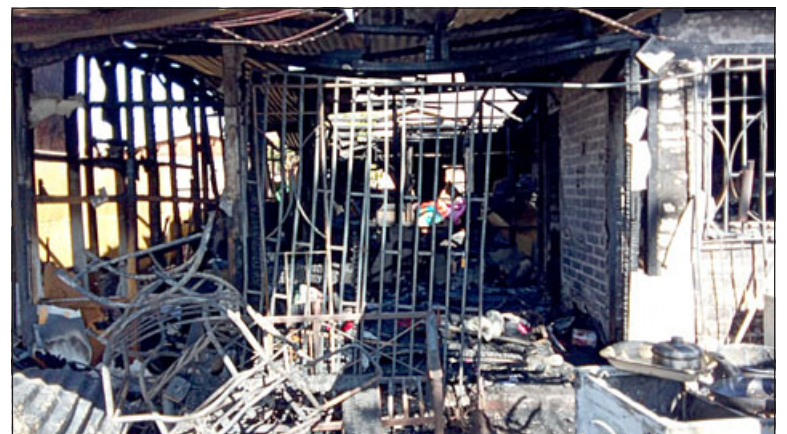
Así quedó la casa después del incendio ocurrido días atrás.
