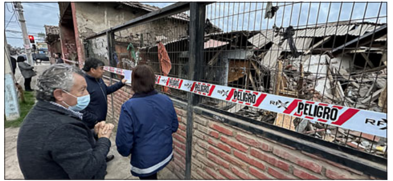
El inmueble se encontraba en condiciones bastante deplorables.
