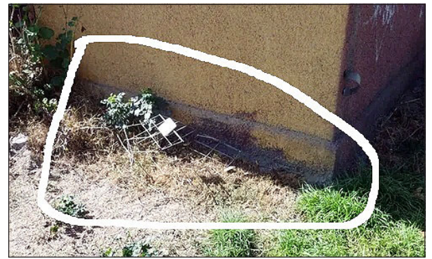
Acá una de las protecciones tiradas en el suelo.
