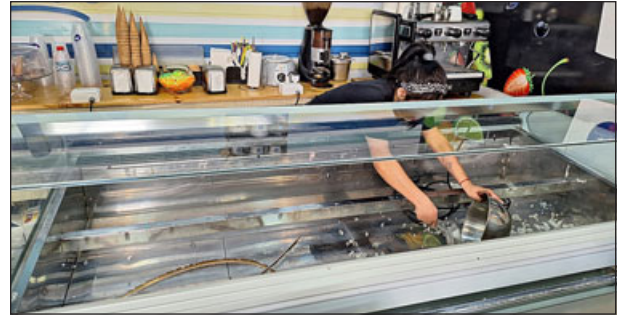
La vitrina refrigerante de la heladería completamente destrozada.
