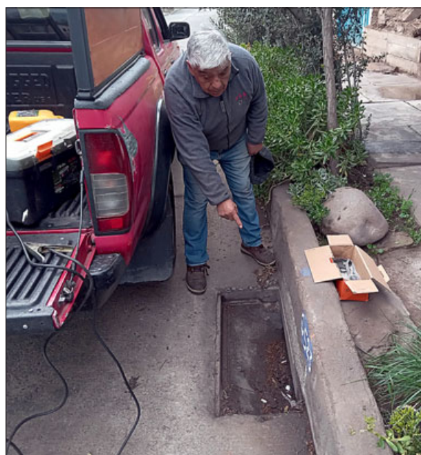
Acá don Jorge nos muestra donde estaba la rejilla, la cual fue robada y hoy constituye un peligro.
