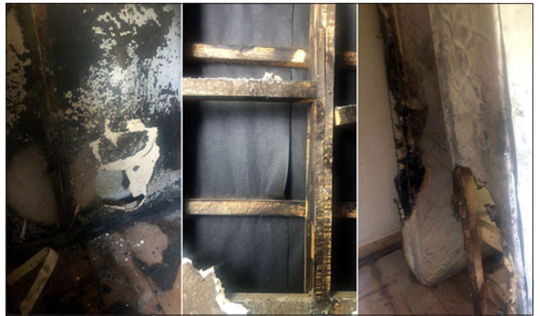
Daños estructurales como asimismo a los enseres del dormitorio dejó el siniestro.
