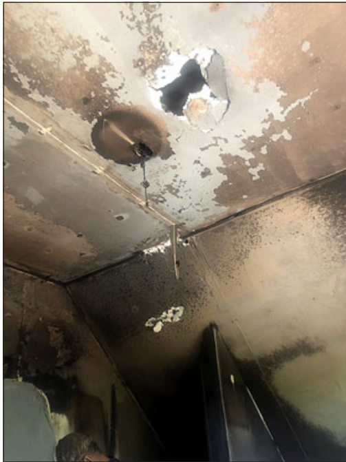
Un desperfecto eléctrico podría ser la causa del incendio, aunque aún Bomberos no han emitido su informe técnico.
